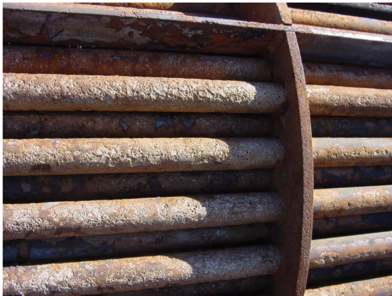
Obrázek 22: Koroze na rekuperačním výměníku tepla
