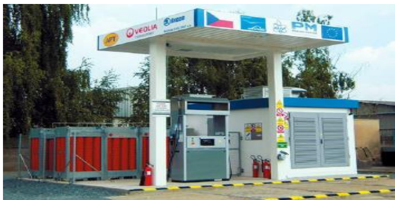
Obr. 20 Čerpací stanice na vodík v Neratovicích [12]
