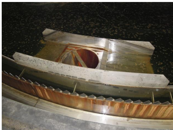
Obrázek 27: Přepad vyčištěné vody [autorka]
