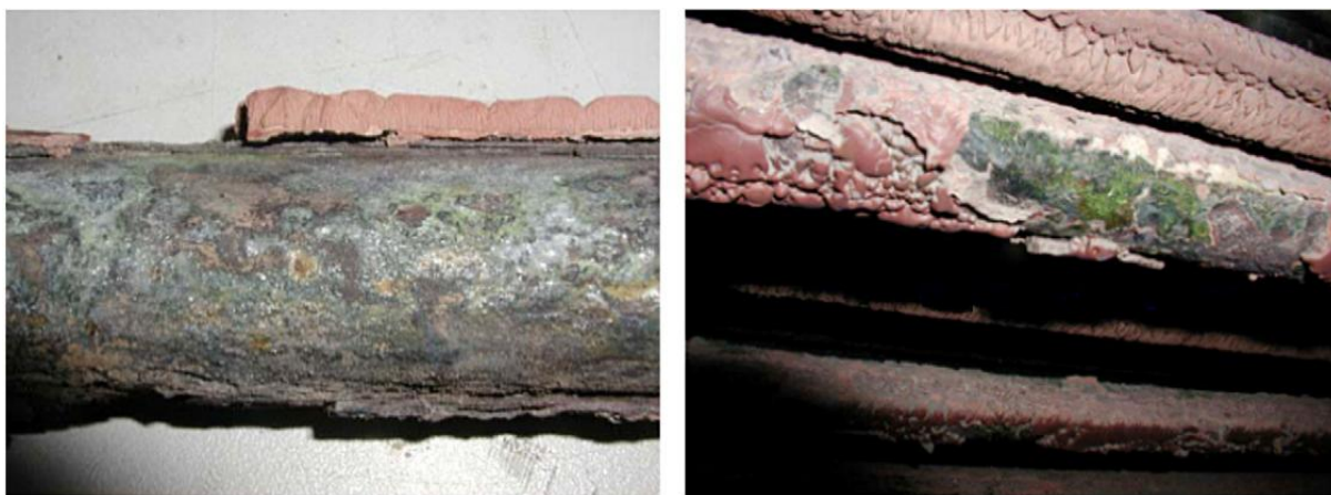
Obrázek 3 Poškození spalovacího zařízení v důsledku koroze způsobené HCl
