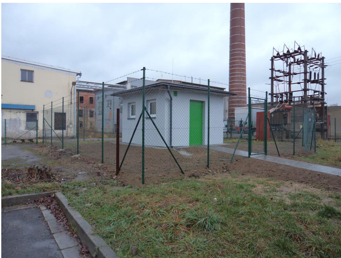
Obr. č. 36, Budova vrtu Perla 06 s oplocením ochranného pásma, (vlastní fotografie)
