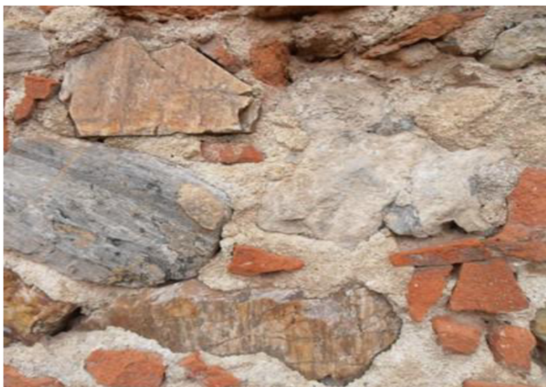
Obr. č. 1 Fotografie historické cemento-vápenné malty
