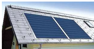
Obrázek 18 Integrace ve střešní krytině
