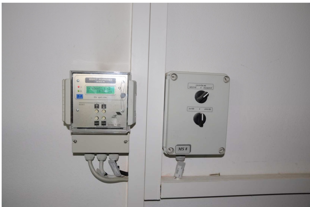
Obrázek 32 - Řídicí jednotka pro záznam měření průtoku [14]
