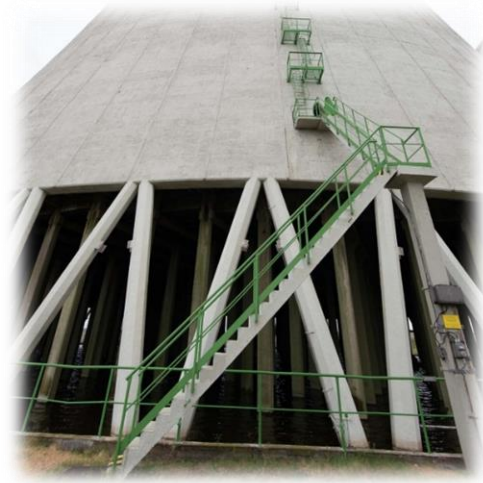
Obrázek 3.4: Spodní část chladicí věže [20]
