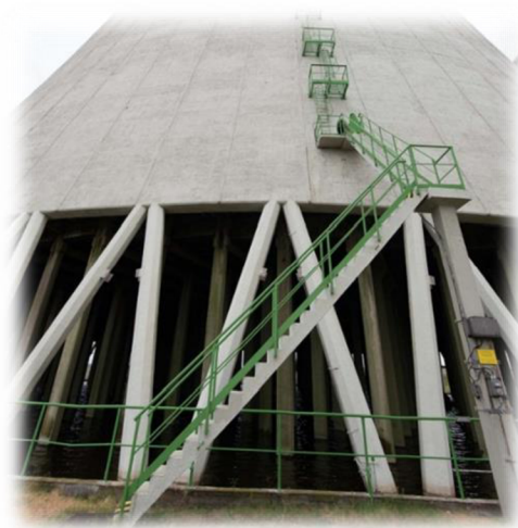
Obrázek 3.4: Spodní část chladicí věže [20]
