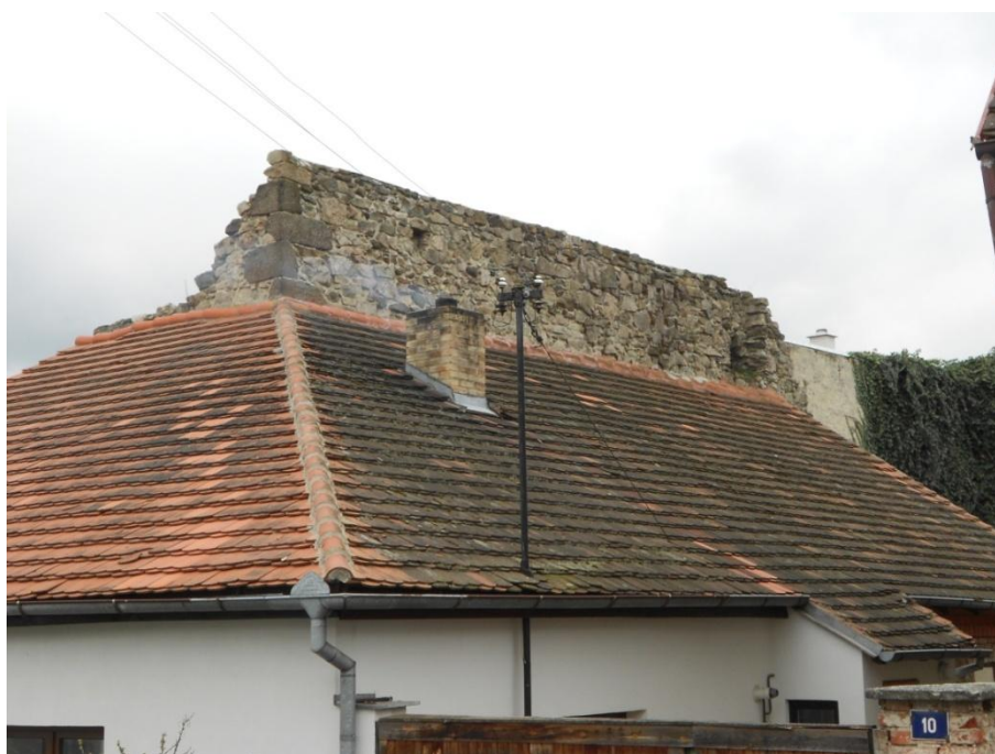
Obr. 36 – Myšenec, pohled na nároží paláce stáčeující s k jihu, pohled od východu (foto autor).
