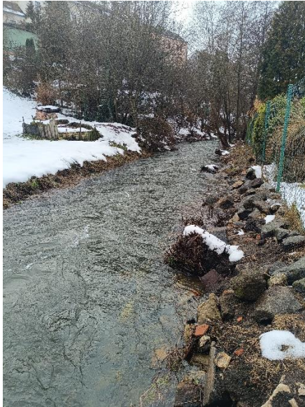
Obrázek 39 – rozpadlé opevnění břehu v úseku 13 (zdroj: vlastní zpracování)
