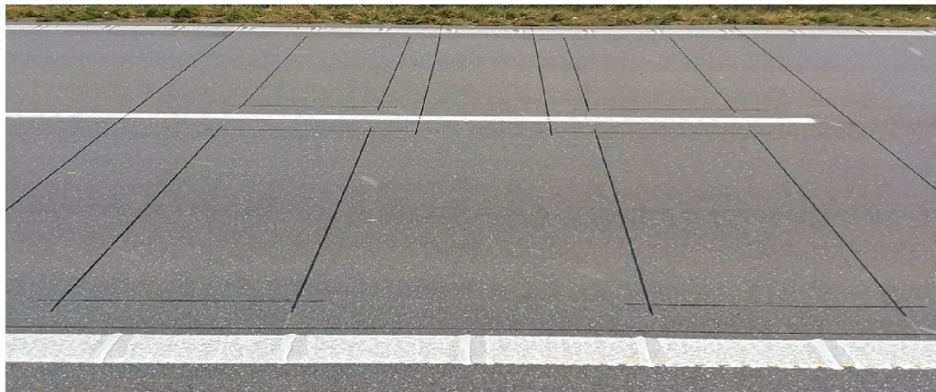
Obr. 13 – Smyčky ve vozovce [autor]
