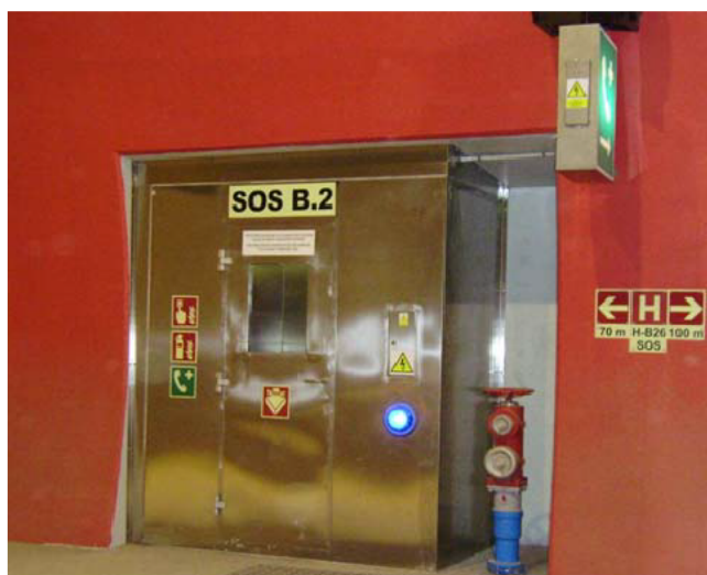
Obr. 10 – Tunelová SOS kabina [13]
