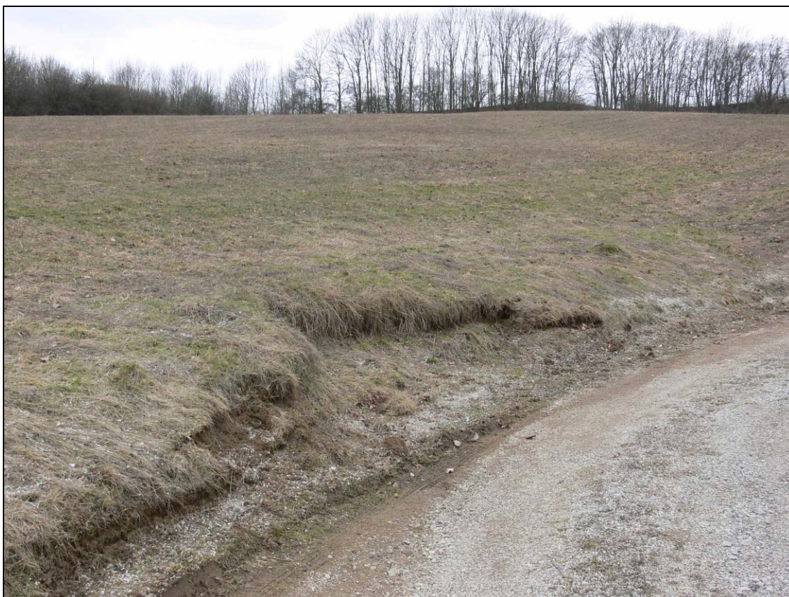
Obr. č. 2 Narušený svah, který je postupně erodován. (Foto D. Kincl)
