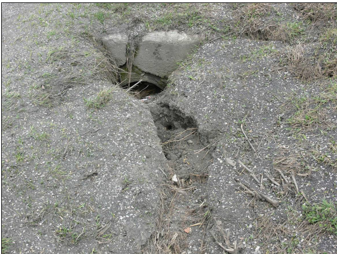
Obr. č. 3 Zanesený příkop a propustek. (Foto D. Kincl)
