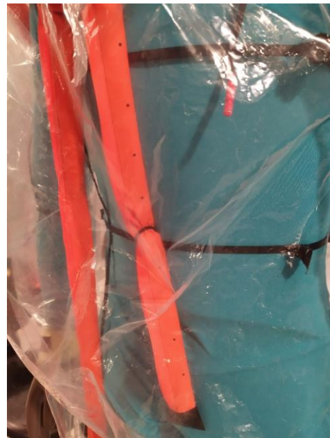
Obrázek 2.10 Slepěné konce vzduchovodů
