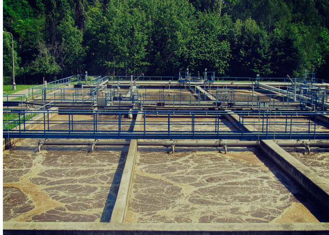
Obr. 2.10: Nádrž aerobního biologického čištění. [1]
