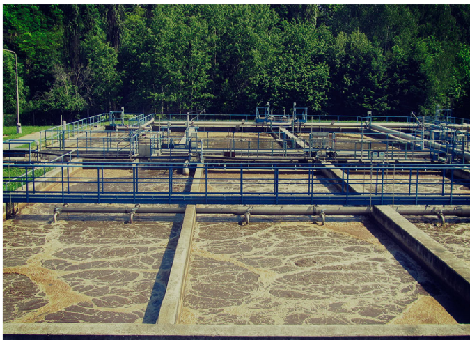
Obr. 2.10: Nádrž aerobního biologického čištění. [1]
