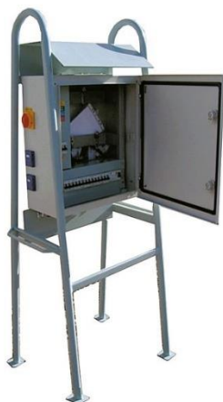
Obr. 6-42 – elektromerový staveniskový rozvádzač [53]
