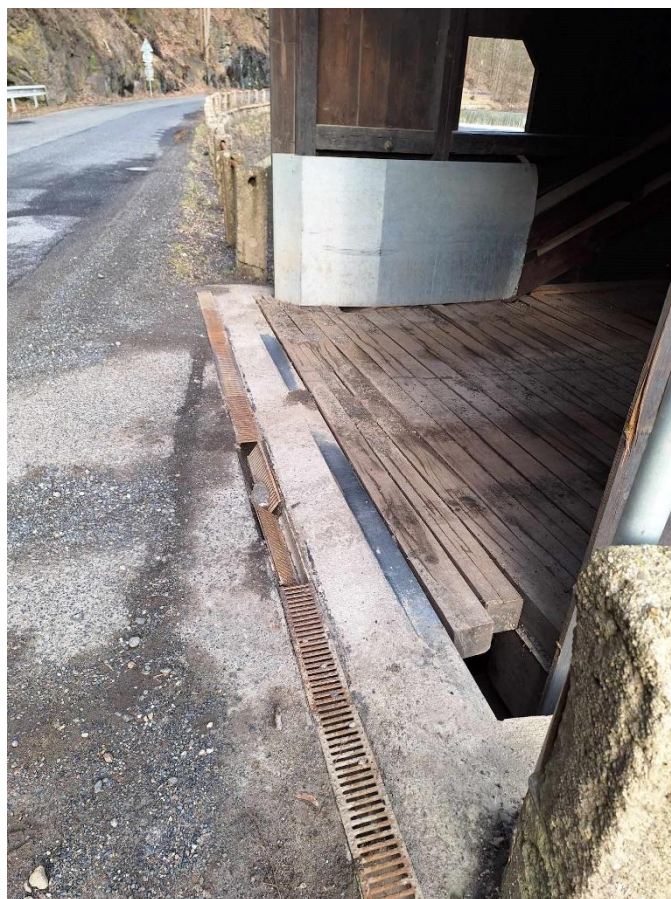
Obrázek 27-Poškození odvodňovacího žlabu (autor)
