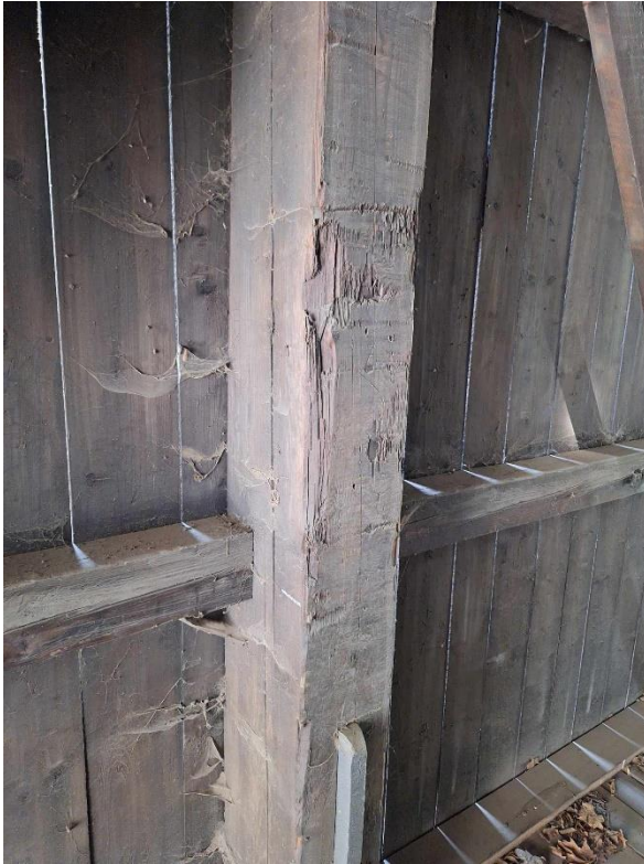
Obrázek 26-Poškození závěsu věšadla (autor)
