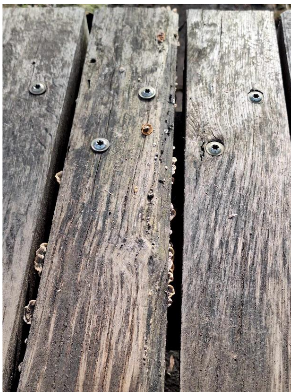
Obrázek 24-Poškození trámu vedlejšího pole mostu (autor)
