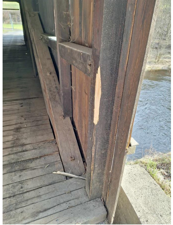
Obrázek 25-Poškození bednění mostu (autor)
