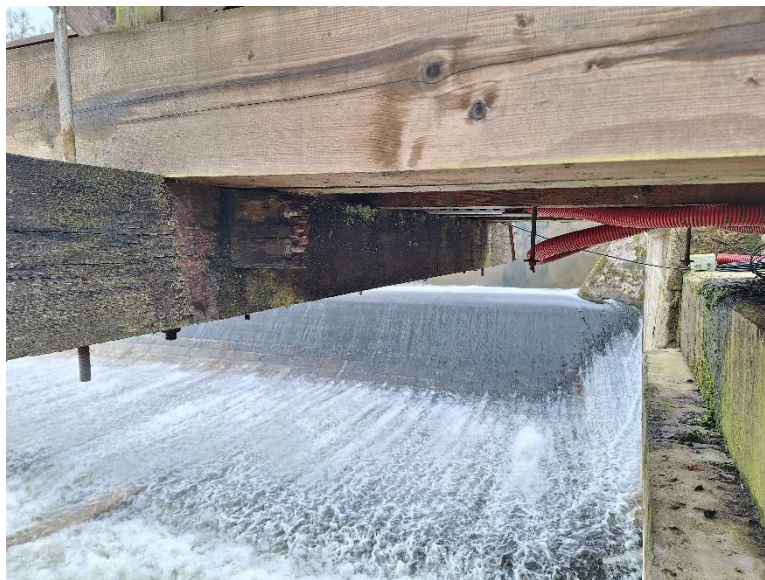
Obrázek 39-Chybějící ztužidlo (autor)
