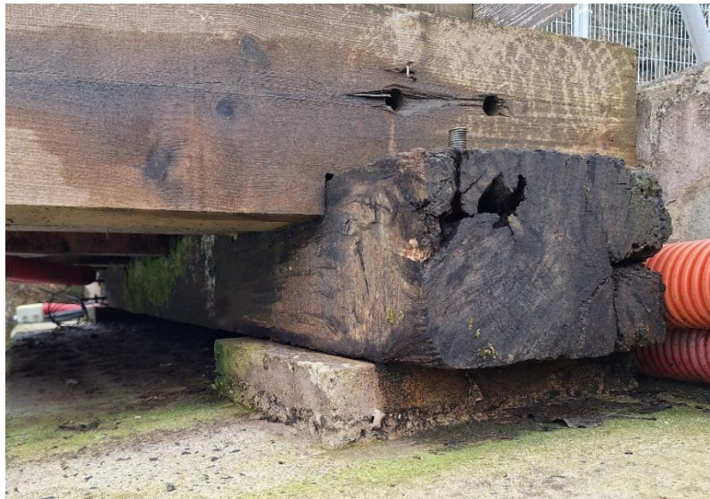
Obrázek 36-Hniloba úložného prahu a chybějícím kováním (autor)
