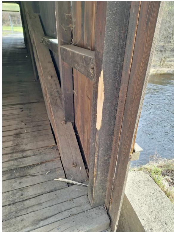
Obrázek 25-Poškození bedněni mostu (autor)
