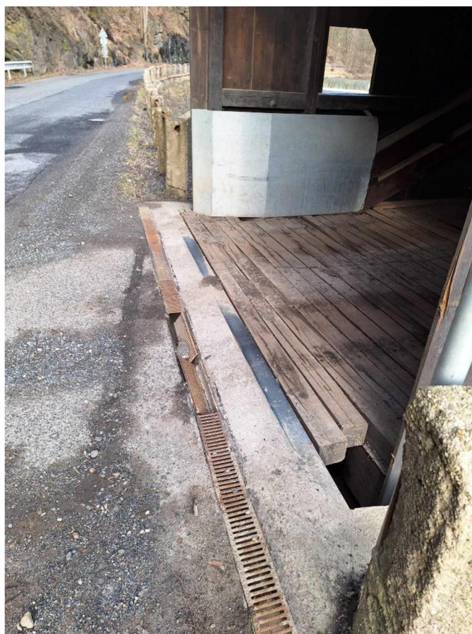
Obrázek 27-Poškození odvodňovacího žlabu (autor)
