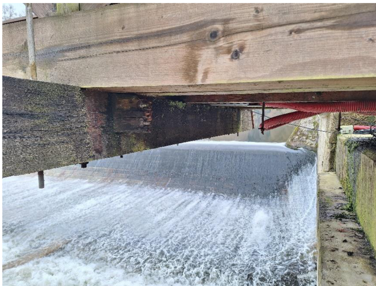
Obrázek 39-Chybějící ztužidlo (autor)
