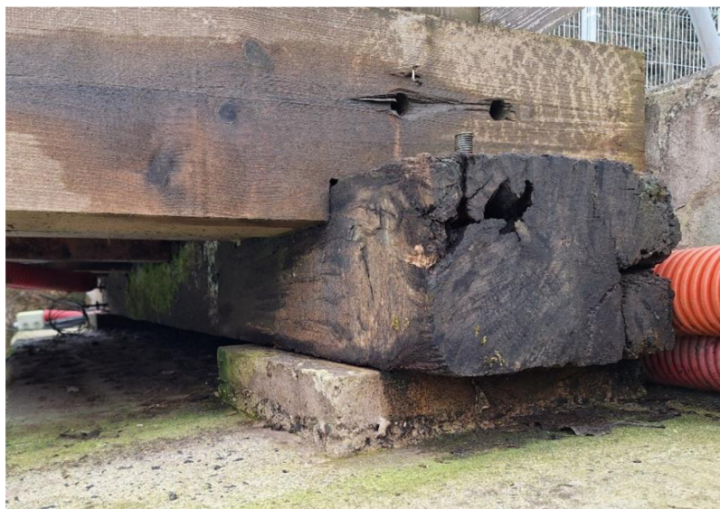
Obrázek 36-Hniloba úložného prahu a chybějícím kováním (autor)
