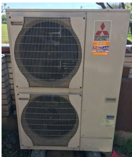
Obrázek 8.9 Umístění tepelného čerpadlo Mitsubishi.
