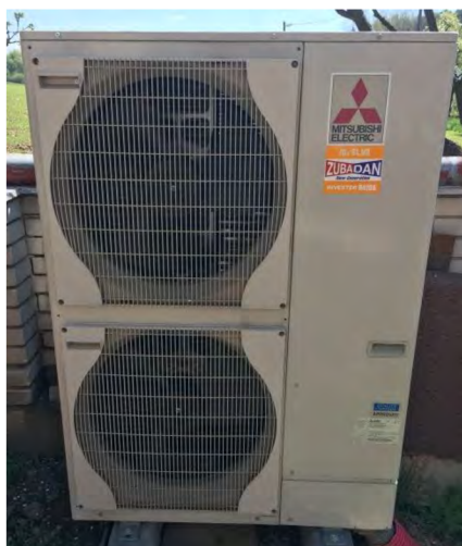
Obrázek 8.9 Umístění tepelného čerpadlo Mitsubishi.
