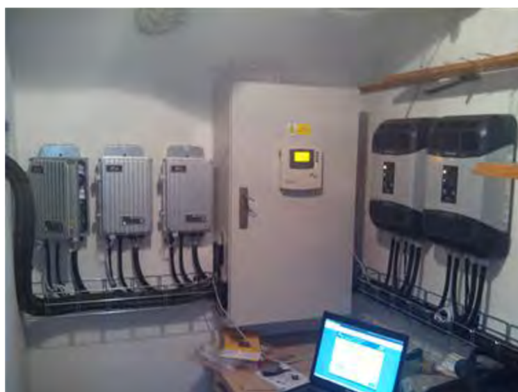
Obrázek 8.7 Technická místnost se střídači a regulátory a monitorovací jednotka.
