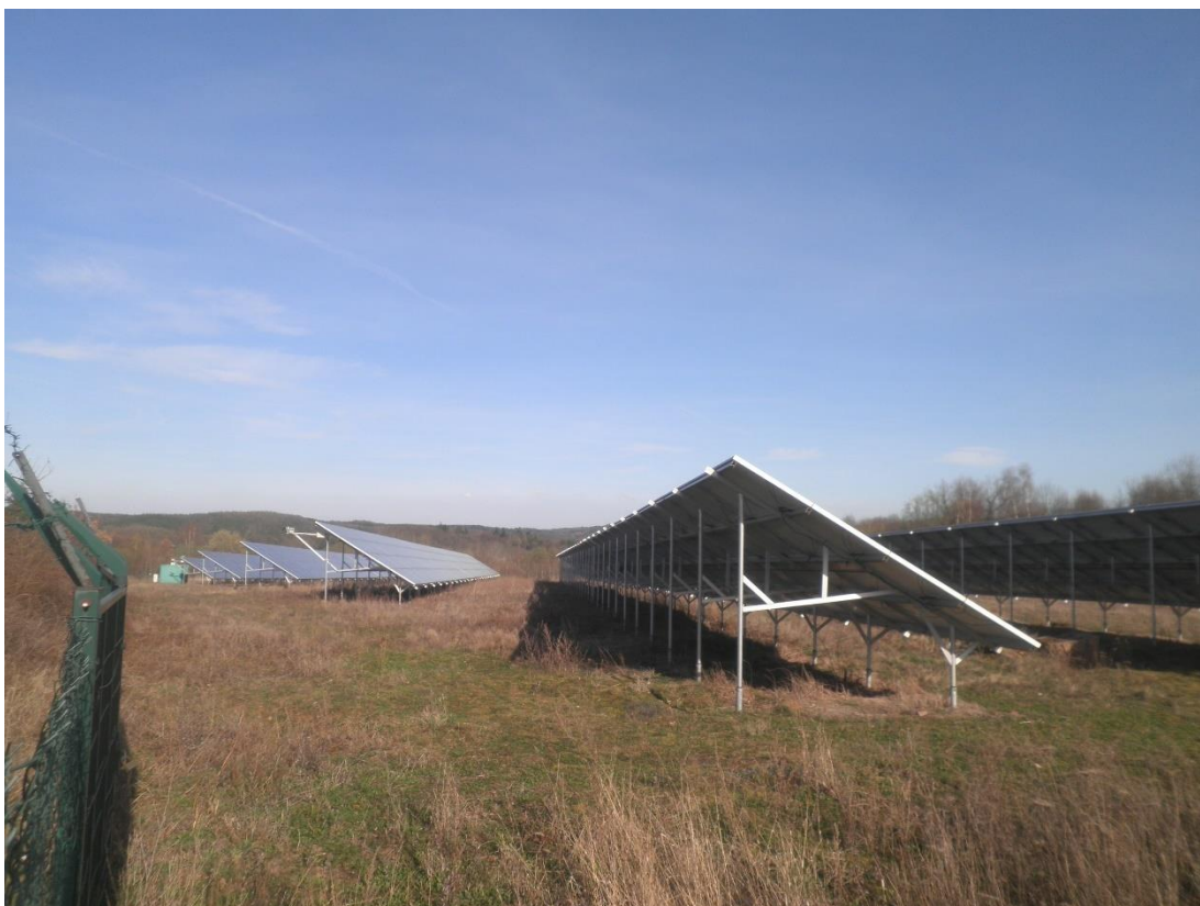
Fotovoltaická elektrárna v areálu bývalé cihelny (Autor, 31. 3. 2017).
