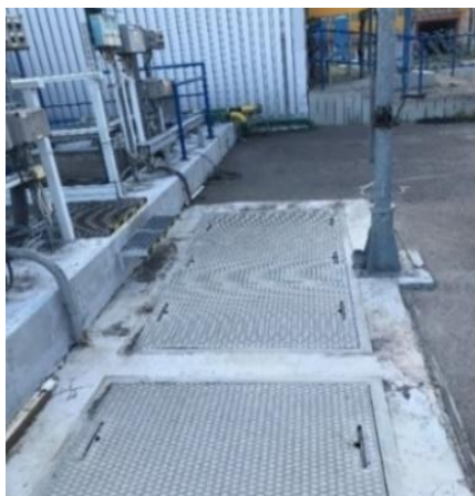
Obrázek 8 - Čerpací stanice vyčištěné splaškové vody (vlastní zdroj)
