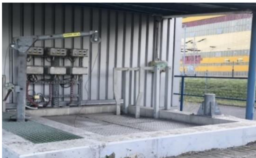
Obrázek 3 - Čerpací stanice s jeřábem na vyjmutí česlicového koše (vlastní zdroj)
