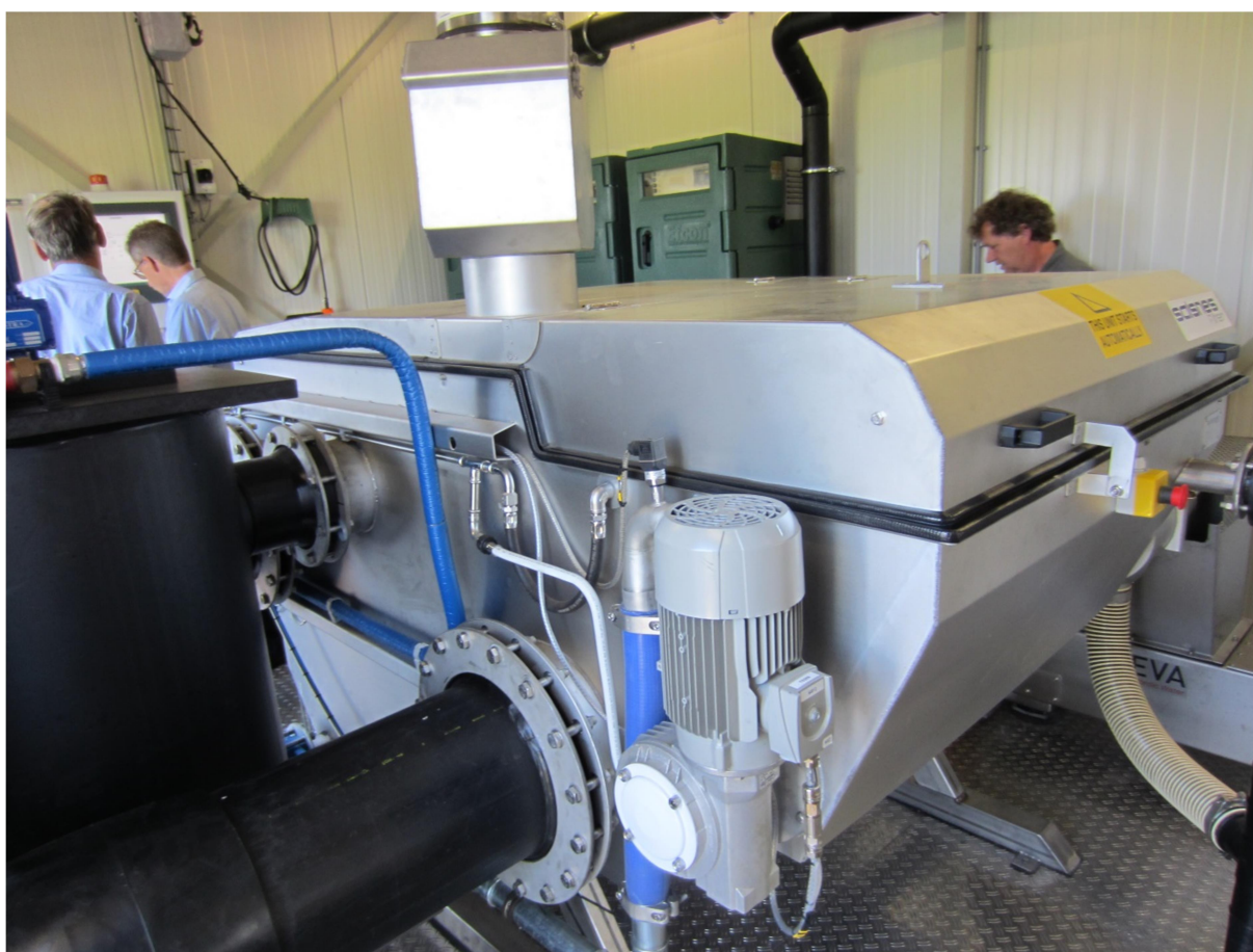
Obrázek 6.3 Pilotní jednotka CADoS, ČOV Ulrum, Nizozemsko [18]
