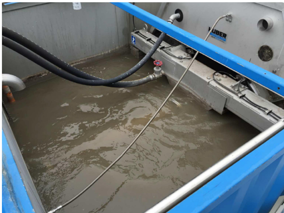
Obrázek 7.16 Vstupní část Drum Screen LIQUID Mesh, měření č. 2, Německo [22]
