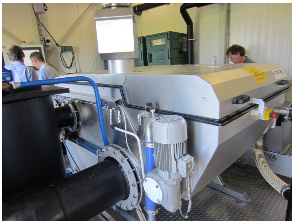
Obrázek 6.3 Pilotní jednotka CADoS, ČOV Ulrum, Nizozemsko [18]
