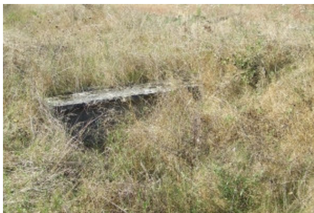
Obr. č. 8: Pohled na zarostlý příkop s propustkem, součást cesty C7 (Boučková 2009)
