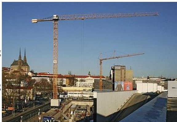
Obr. 5.2. Věžový jeřáb Liebherr 110EC-B6 [19]
