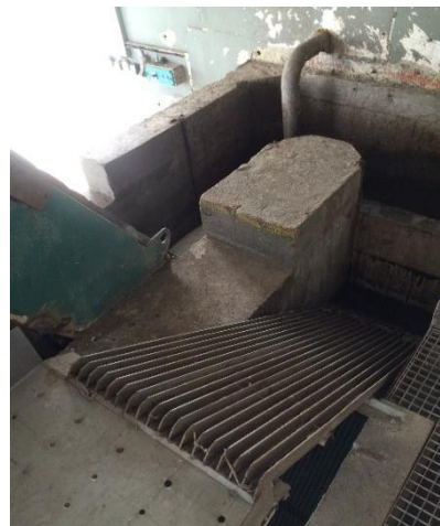
Obrázek č. 2: Jemné česle (ČOV Vodňany)
