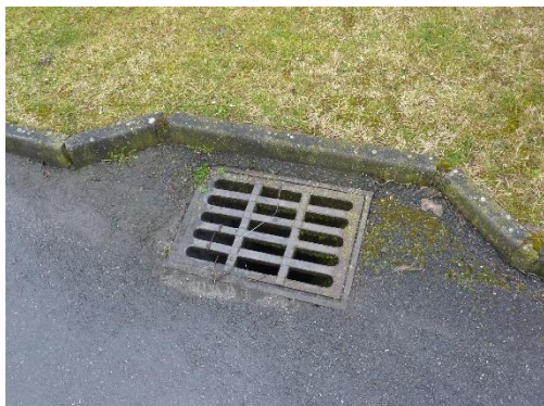
Obrázek č. 24: Kanalizační dešťová vpust' v obci Velké Hydčice
