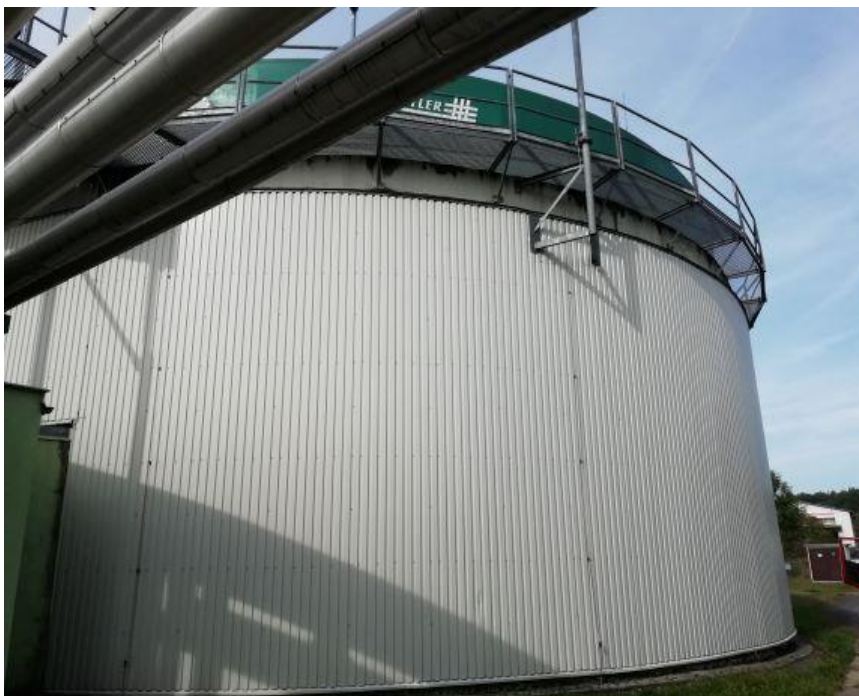
Obr. č. 15 - Vyhňivací nádrž 2 ČOV – Drahovice (foto autor, 2019)
