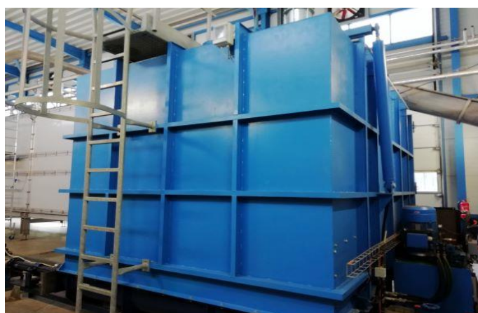
Obr. č. 17 – Zásobník kalů ČOV – Drahovice ( foto autor, 2019)
