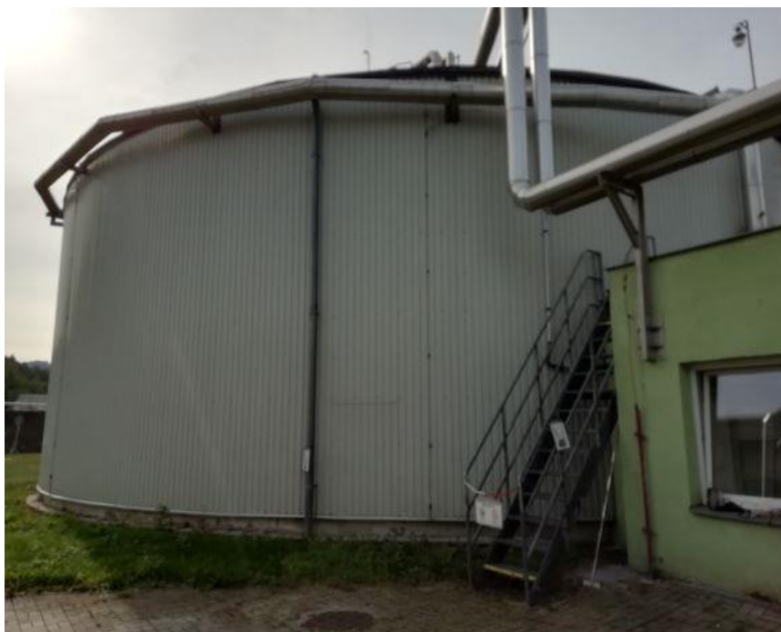
Obr. č. 14 - Vyhňivací nádrž 1 ČOV – Drahovice (foto autor, 2019)
