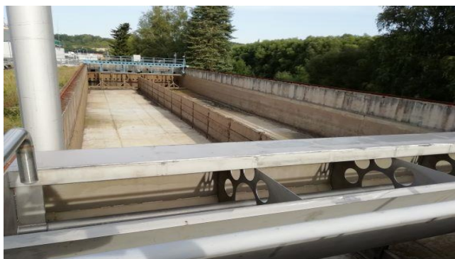
Obr. č. 10- Záložní dešťová nádrž ČOV – Drahovice (foto autor, 2019)
