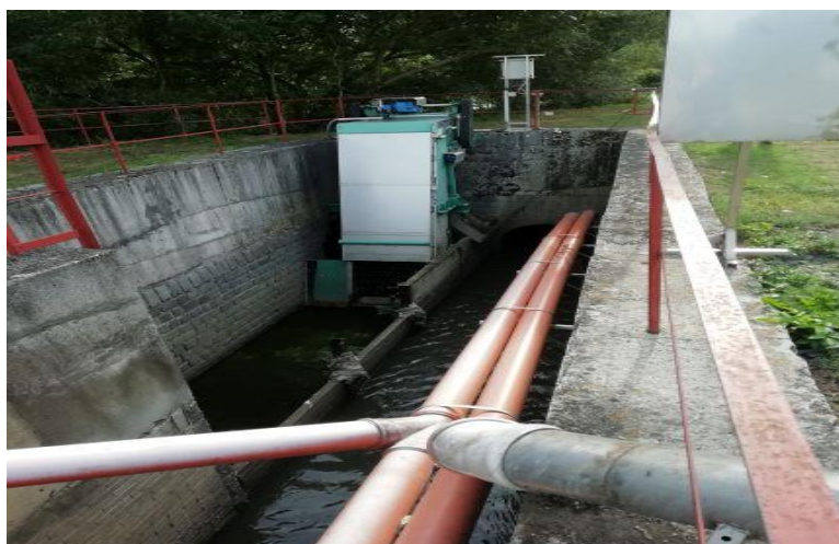
Obr. č. 6 - Přítok do ČOV – Dražovice (foto autor, 2019)
