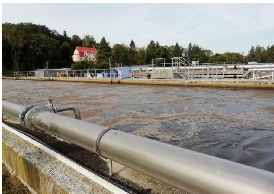
Obr. č. 12- Denitrifikační část nádrže ČOV – Drahovice (foto autor, 2019)
