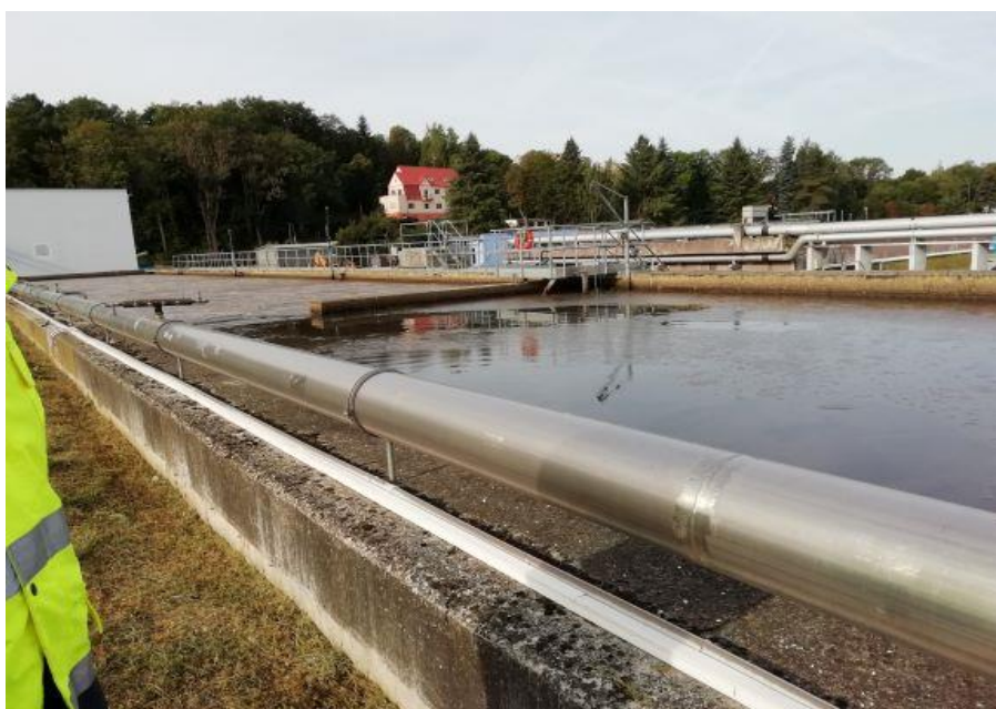
Obr. č. 11 - Nitrifikační část nádrže ČOV – Drahovice ( foto autor, 2019)
