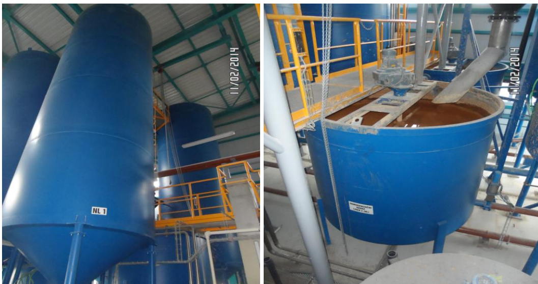
foto č. 32- 33, Pohled na tzv. usazovací špice a homogenizační nádrž v kalovém hospodářství na ÚDV Emerán (foto: vlastní, 02/2014)
