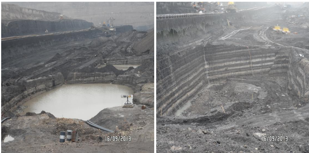
foto č. 20- 21, Původní retence HČS a nově budovaná retence HČS (foto: vlastní 09/2013)
