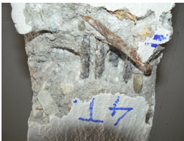
Obrázek 2.8: Rozsáhlá sekaná sonda na trámu [10]
