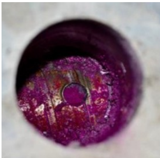
Obrázek 2.14: Návrvt k ocelové chrániče Sandrik v předpjatém nosníku, následné vylomení vývrtu, dovtřetí k výztuži a realizace fenolftaleinové zkoušky [16]
