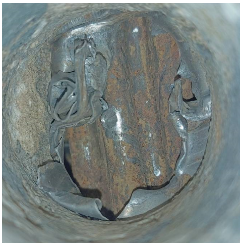
Obrázek 3.47: 4. DC, sonda S106 – obnažený kabel je v ocelové chráničce, na kabelu jsou známky koroze s oslabením profilu a není zainjektovaný [40]
