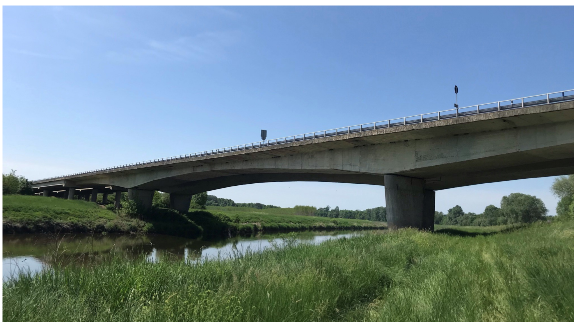
Obrázek 3.2: Pohled na levý most hlavního mostního objektu, hlavním nosným prvkem je komorový nosník proměnné výšky průřezu
