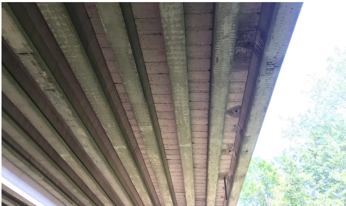
Obrázek 3.4: Pohled na předpolí levého mostu na českou stranu, 14. pole, v krajní části je patrná nefunkční izolace, stopy po zatékání a průsaky v místech odvodňovačů, inkrustace, odpadaná krycí vrstva betonu a v návaznosti i obnažená zkorodovaná měkká výztuž
