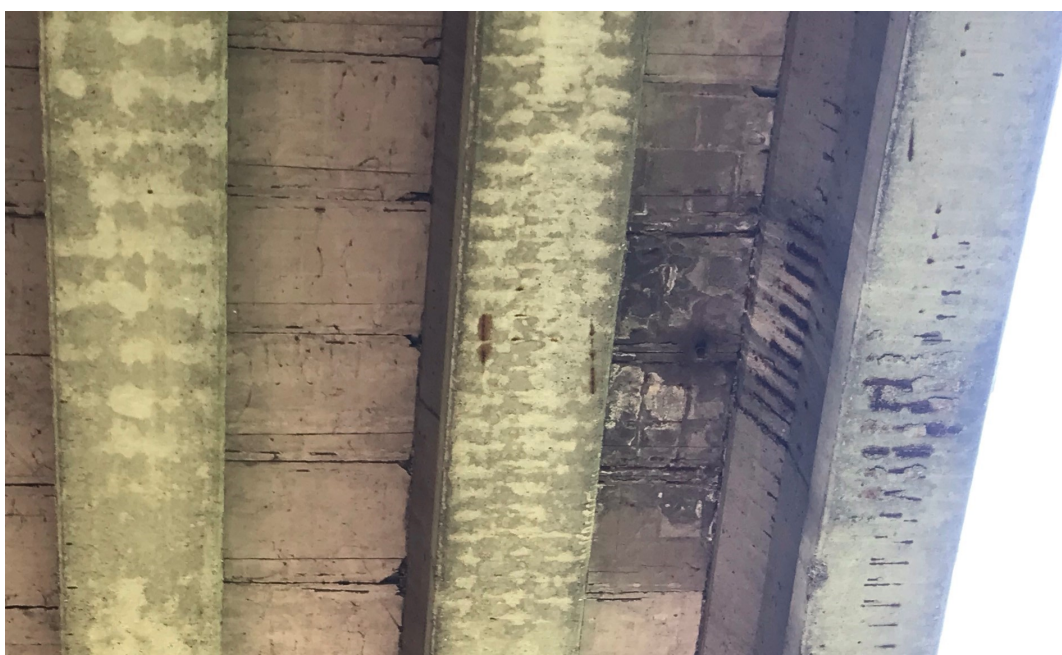
Obrázek 3.5: Detail obrázku 3.4 – nefunkční izolace, stopy po zatékání a průsaky, inkrustace, odpadaná krycí vrstva betonu a v návaznosti i obnažená zkorodovaná měkká výztuž
