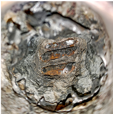
Obrázek 3.46: 3. DC, sonda S63 – obnažený kabel je v ocelové chráničce, na kabelu jsou známky koroze s oslabením profilu, je plně zainjektovaný a injektážní malta je suchá [42]
