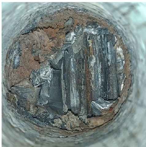
Obrázek 3.44: 1. DC, sonda S23 – obnažený kabel je v ocelové chráničce, která je zkorodovaná, na kabelu jsou známky mírné koroze bez oslabení profilu, je plně zainjektovaný a injektážní malta je vlhká [38]
