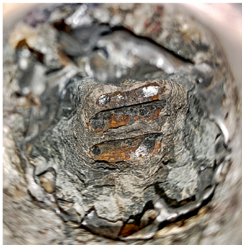
Obrázek 3.46: 3. DC, sonda S63 – obnažený kabel je v ocelové chráničce, na kabelu jsou známky koroze s oslabením profilu, je plně zainjektovaný a injektážní malta je suchá [42]
