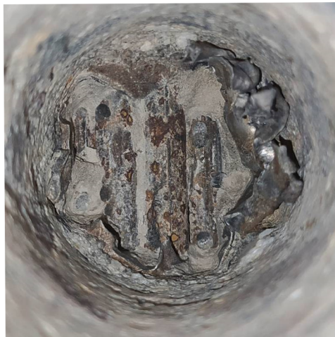
Obrázek 3.48: 6. DC, sonda S123 – obnažený kabel je v ocelové chrániče s povrchovou korozí, na kabelu jsou známky koroze s oslabením profilu do 10 %, je plně zainjektovaný a injektážní malta je suchá [41]
