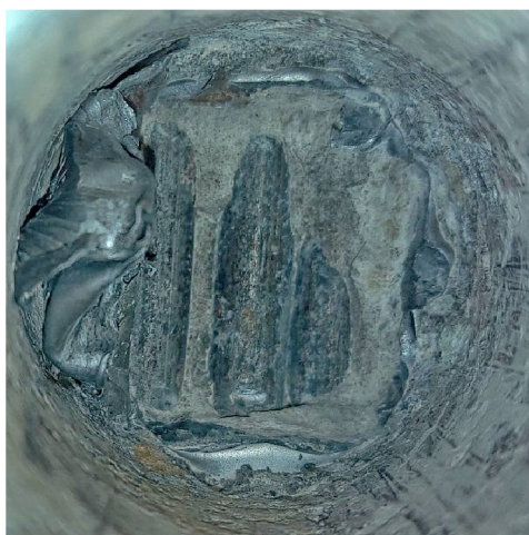
Obrázek 3.45: 2. DC, sonda S42 – obnažený kabel je v ocelové chráničce, kabel je bez koroze, je plně zainjektovaný a injektážní malta je suchá [39]
