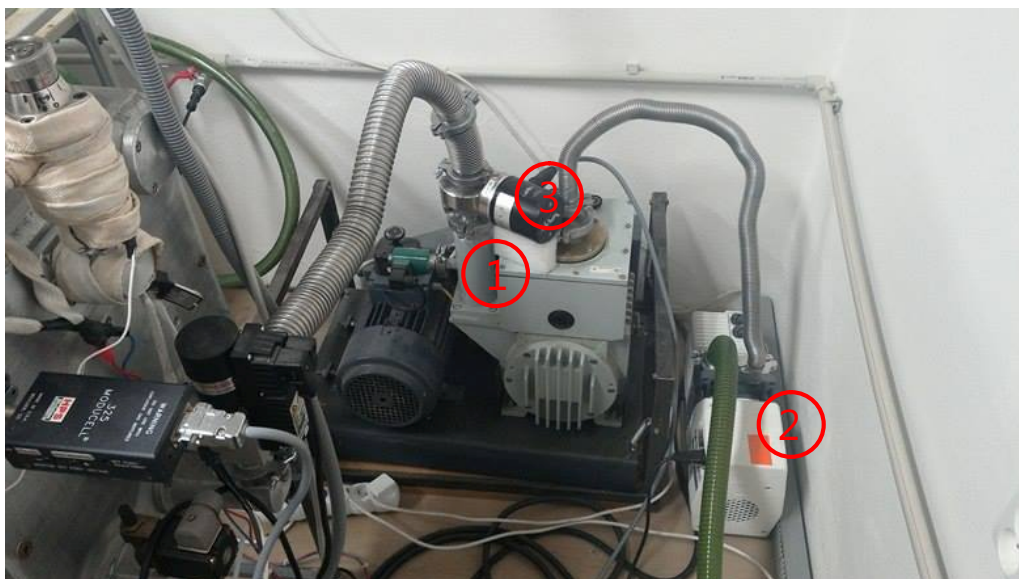
Obrázek 10: Systém čerpání sériově pracujících vývěv
