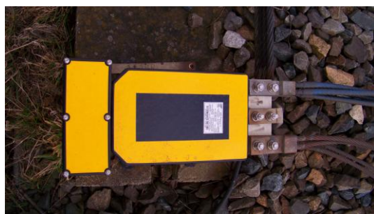
Obr. 1: Vyhodnocovací zařízení kolejového obvodu.
