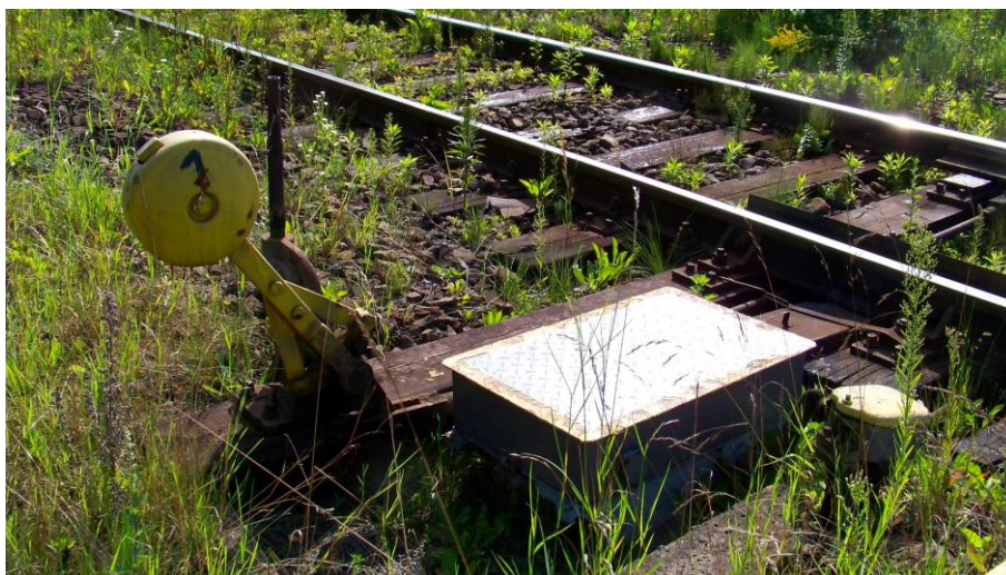
Obr. 9: Výhybka vybavena elektromotorickým přestavníkem.
