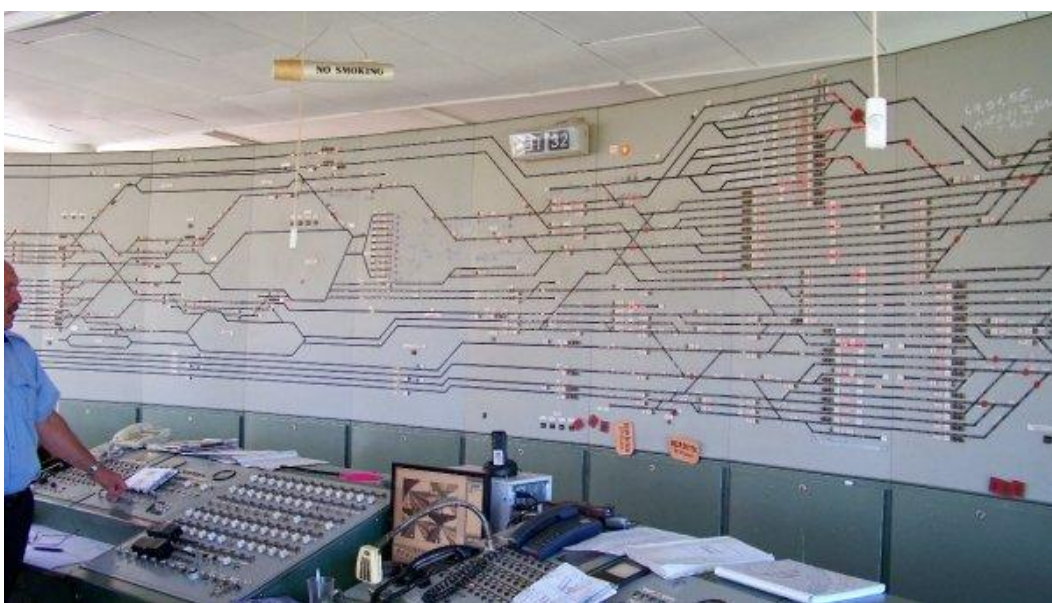
Obr. 10: Zadávací úroveň reléového zabezpečovacího zařízení v České Třebové.
