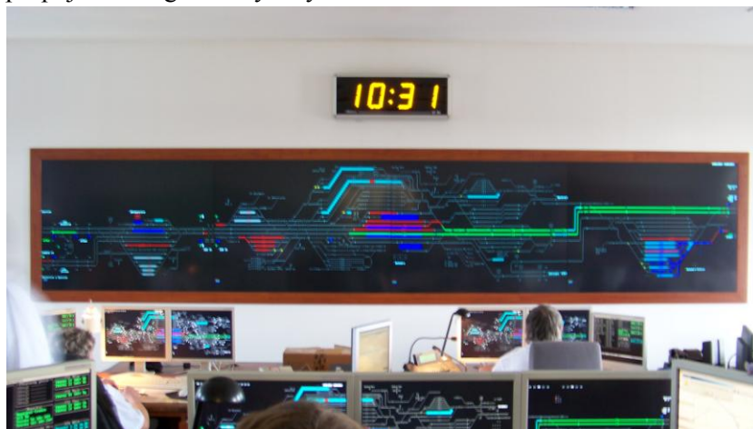
Obr. 12: Zadávací úroveň ESA 11, ústřední stavědlo Bohumín.
