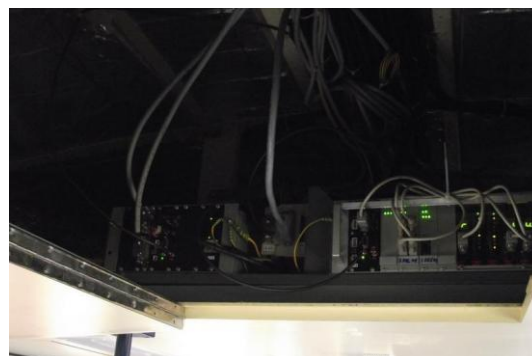
Obr. 14: Technické vybavení pro činnost terminálu. [10]
