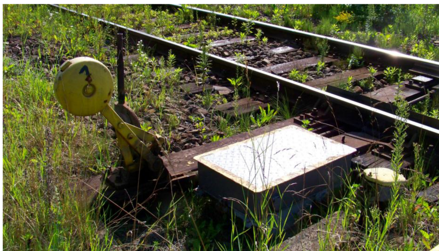
Obr. 9: Výhybka vybavena elektromotorickým přestavníkem.
