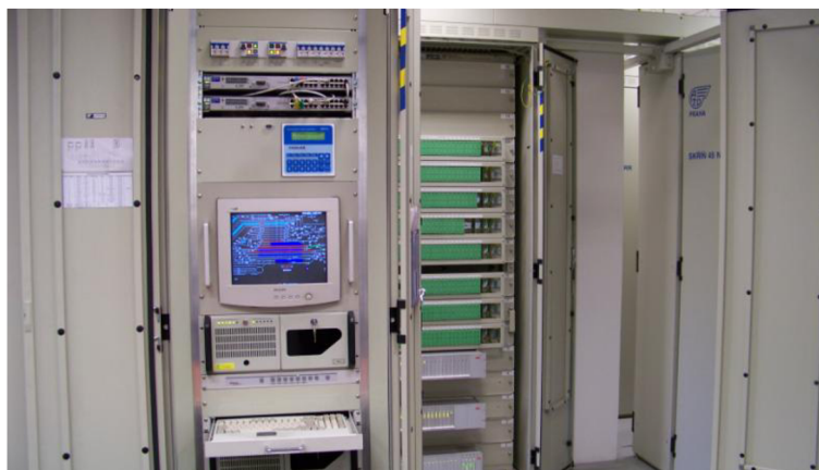
Obr. 11: Řídící úroveň ESA 11, ústřední stavědlo Bohumín.
