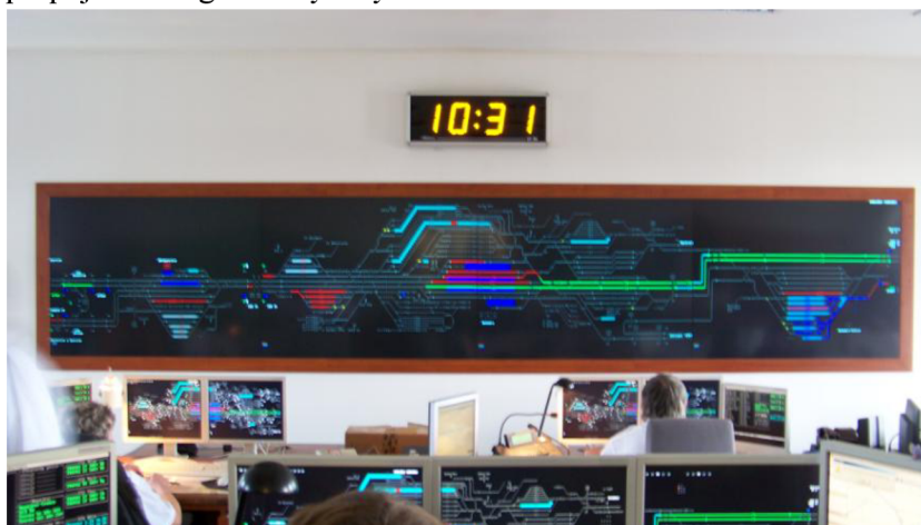
Obr. 12: Zadávací úroveň ESA 11, ústřední stavědlo Bohumín.
