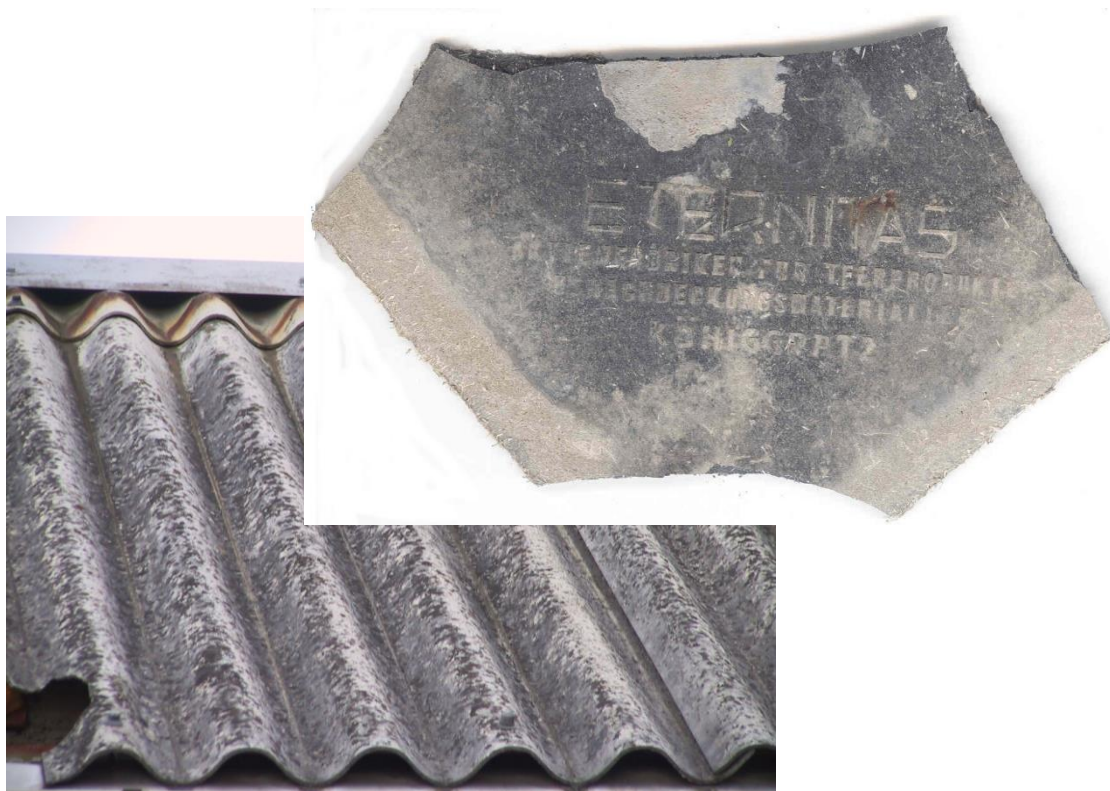
Obr. 2: Střecha z vlnitého Eternitu a deskového Eternitu z produkce hradecké firmy Eternitas akciové továrny dehtových výrobků a krycích hmot v Hradci Králové (kolem roku 1920)
