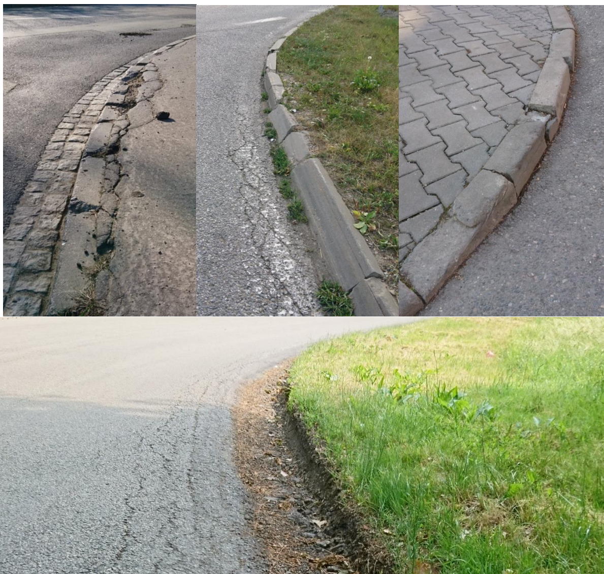
Obrázek 1 - Poškození okrajových částí vozovky pojezdem vozidla
