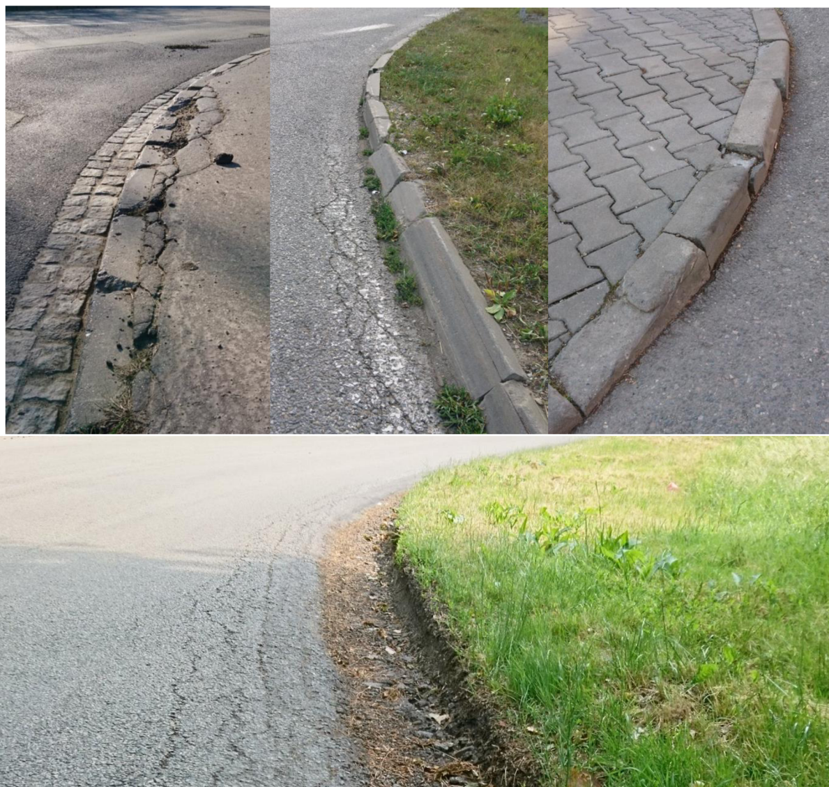
Obrázek 1 - Poškození okrajových částí vozovky pojezdem vozidla
