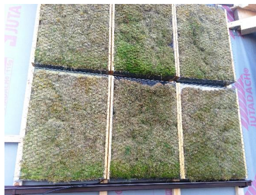
Obr. 4-5: Růst mechu pouze ve spodních částech zavlažovaných panelů
