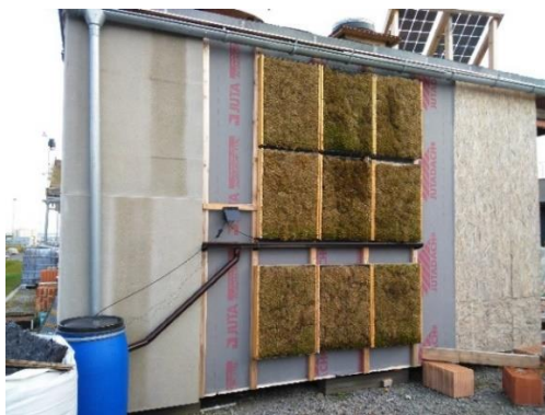
Obr. 4-4: Mechové panely instalované na testovacím objektu v Centru AdMaS, 09/2017
