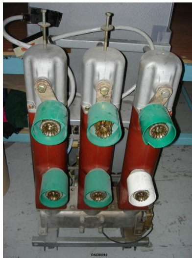
Obr. 3.3 Vypínač VF ABB plnený plynom SF 6 .
