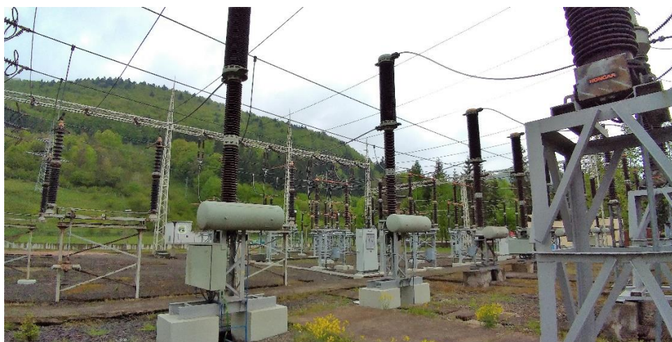
Obr. 9.1 Vypínač S1-245 v rozvodni R220kV.
