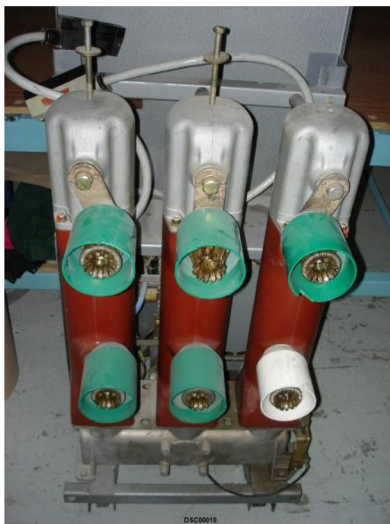
Obr. 3.3 Vypínač VF ABB plnený plynom SF 6 .
