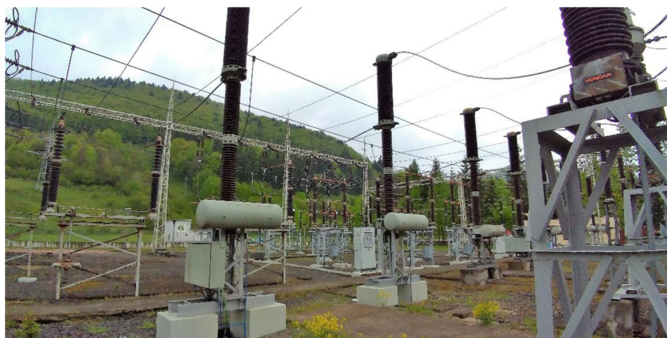
Obr. 9.1 Vypínač S1-245 v rozvodni R220kV.
