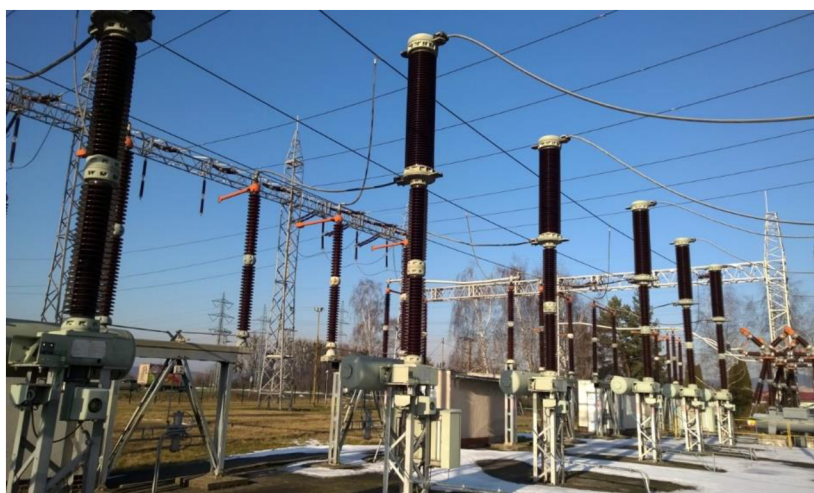
Obr. 5.1 Vypínač AEG S1-245 rozvodňa R220kV.
