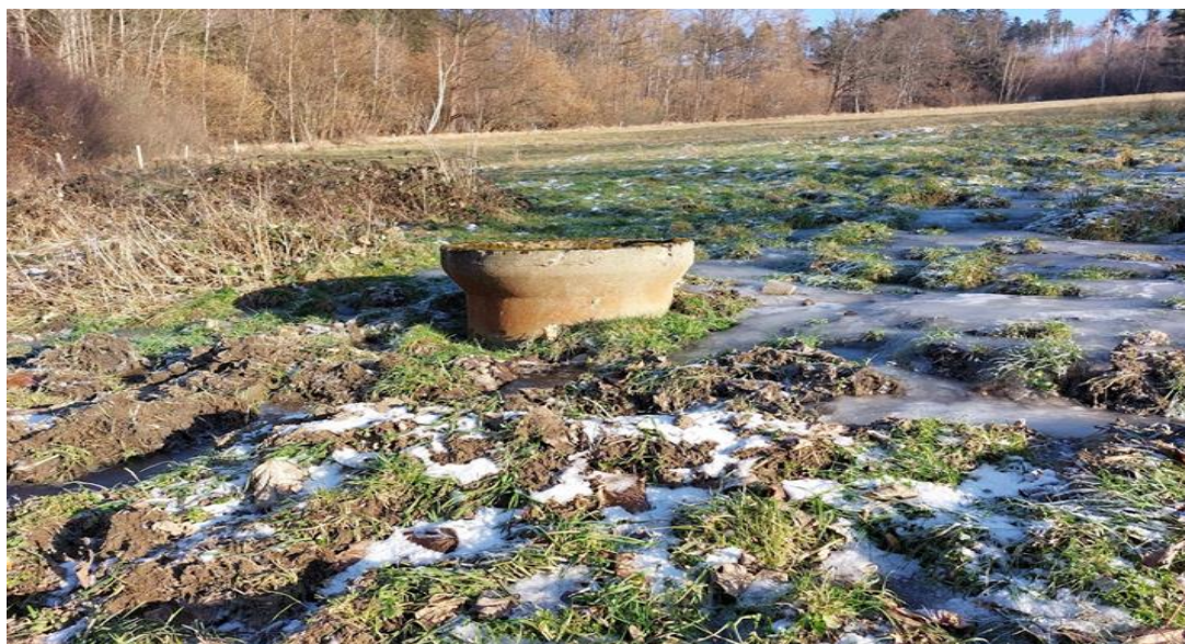
Obrázek 3.5: Ukázka nefunkčního odvodnění, pastviny nad obcí Sušice (Janda, 2023)
