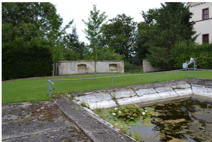
Foto č. 7 – požární nádrž v horní části zkoumaného území. Je značně zanedbaná. Zábradlí a osvětlení je nedostačující. Okolní zpevněná část nádrže je ve špatném stavu. Nachází se u ní dva nově vysazení jedinci Ginko biloba v pyramidálním kultivaru.
