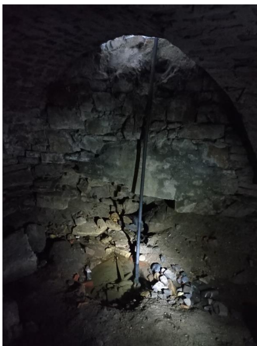
Obr. 88 Zdroj vody, která zaplavuje kryptu v kostele sv. Jana Křtitele ve Staré Vsi nad Ondřejnicí, detail
