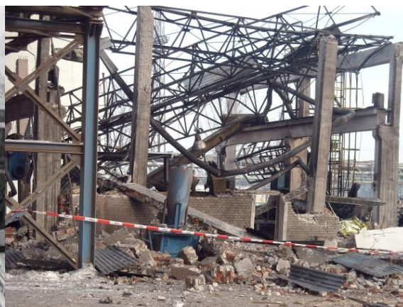
Obr. 19 Výbuch v elektrárně Dolna Odra. [11]
