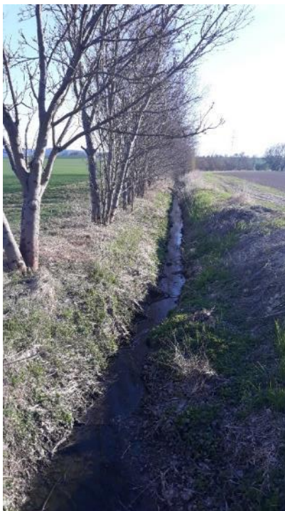
Napřímené, zahloubené koryto toku
