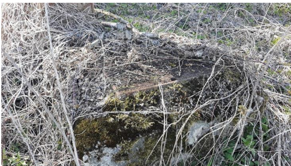
Poklop šachty vedoucí do zatrubněného toku
