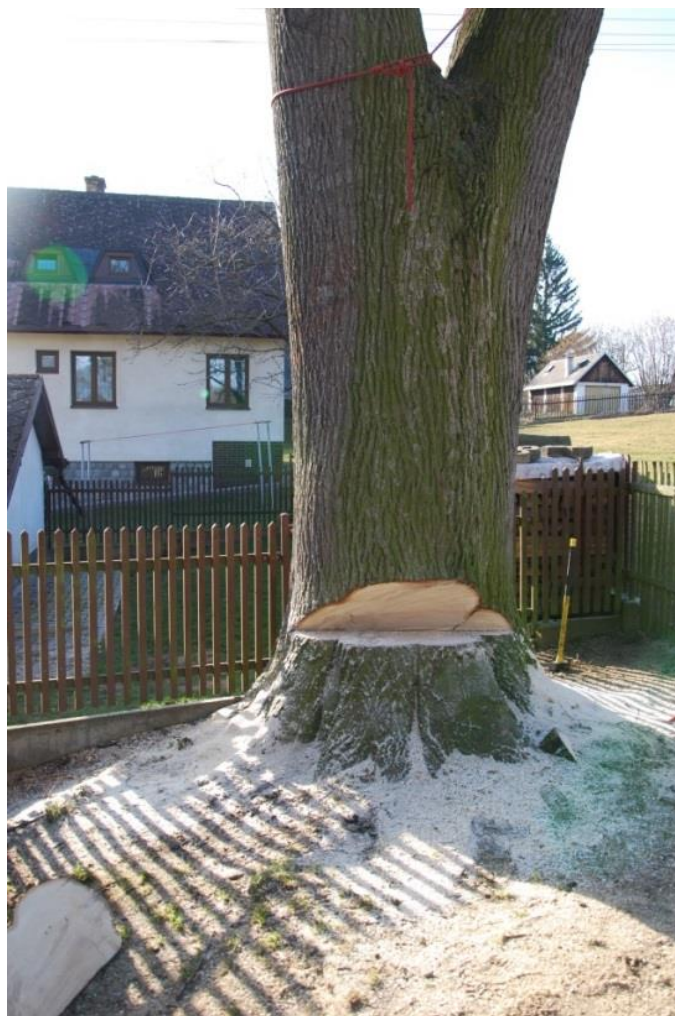
Obr. 23: směrový zásek nám určuje směr, kterým potřebujeme strom pokácet, ke zvýšení bezpečnosti lze použít i směrového lana
