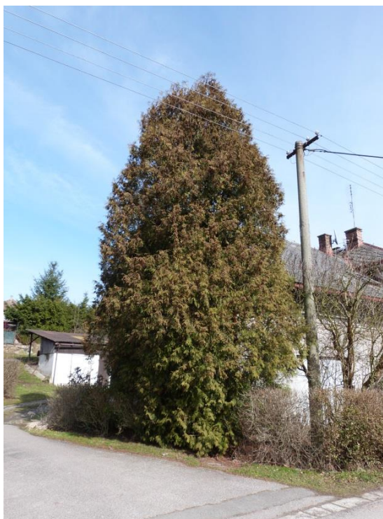
Obr. 50 – modelový příklad 5 – Thuja occidentalis , kácení postupné bez spouštění, průměr kmene 290 mm, překážkou dům, živý plot a elektrické vedení
